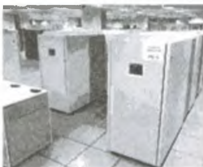
Sprzęt telekomunikacyjno-sieciowy odpowiedzialny m.in. za load balancing
