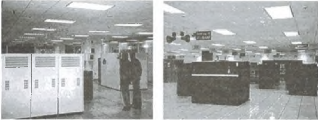
Widok na główną halę Centrum Danych systemu Galileo (w tle serwery bazodanowe pracujące na platformie AS/400)
