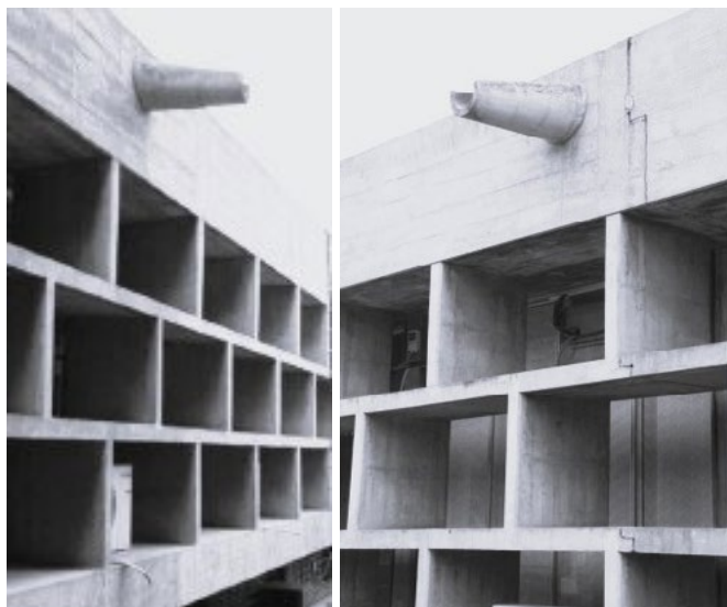
Ilustracja 4. Rádio Nacional de Angola, Luanda, Angola (1963–1967) – Fernão Simões de Carvalho. Detal Brise-soleil. Źródło: A. Magalhaes, Modern Movement Migrations... , op. cit. , s. 39.
