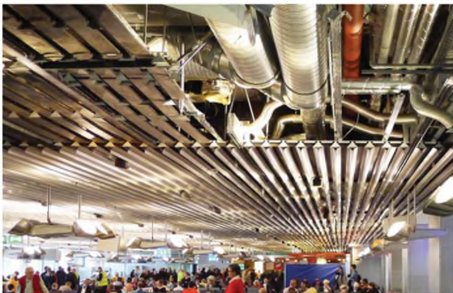
3.3-19. Poczekalnia przedodlotowa w terminalu we Frankfurcie w czasie przebudowy. Po zdjęciu elementów sufitu podwieszonego widoczna przestrzeń międzystropowa wypełniona instalacjami, poniżej indywidualnie zaprojektowane oprawy oświetleniowe. Jest to standardowe rozwiązanie, stanowiące duży problem projektowo-realizacyjny i eksploatacyjny współczesnej architektury użyteczności publicznej. Poważne trudności nastręcza umieszczenie kanałów klimatyzacji i wentylacji, kabli elektrycznych, instalacji przeciwpożarowych itp. w ograniczonej wysokości, ich wzajemna koordynacja oraz serwisowanie w trakcie eksploatacji.
