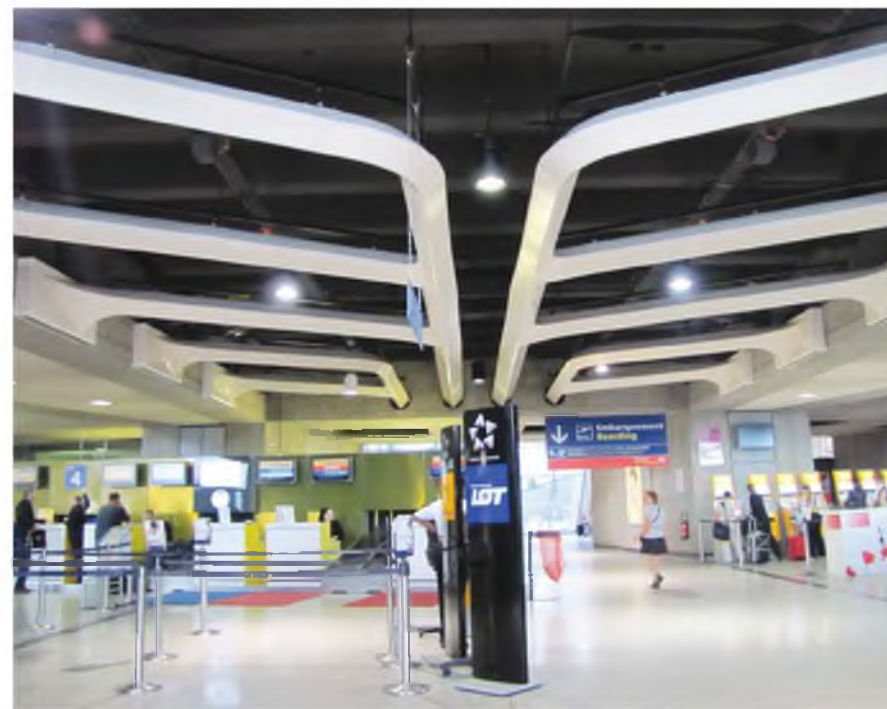
3.3-22. Terminal T1 na lotnisku Roissy w Paryżu. Specjalnie zaprojektowane gałęziowe kanały instalacji klimatyzacji zostały wyeksponowane na tle ciemnego sufitu. W trakcie gruntownej renowacji obiektu w ostatnich latach zostały pieczołowicie odnowione jako pełnoprawny element dzieła architektonicznego.
